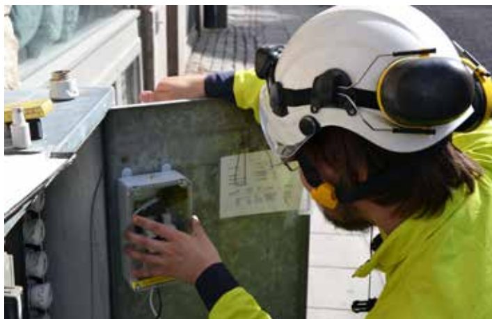
Installation av BT-meshnod i kabelskåp.
