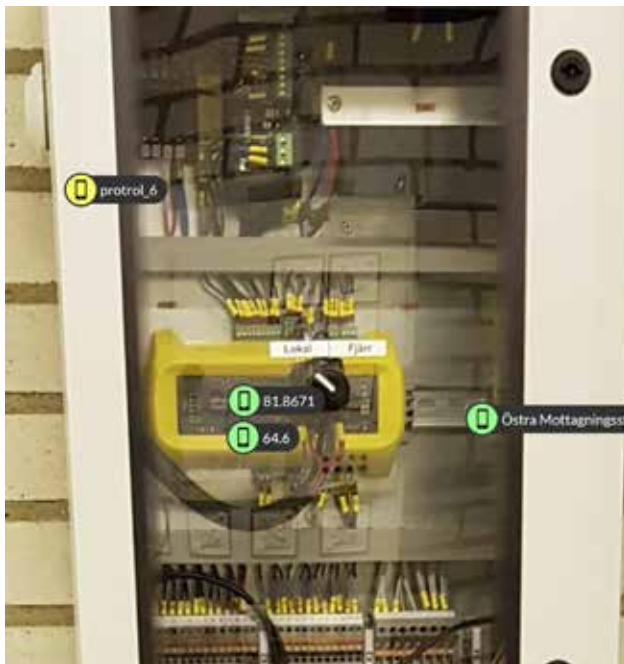
Sensorer i nätstation. Foto: Krafringen
