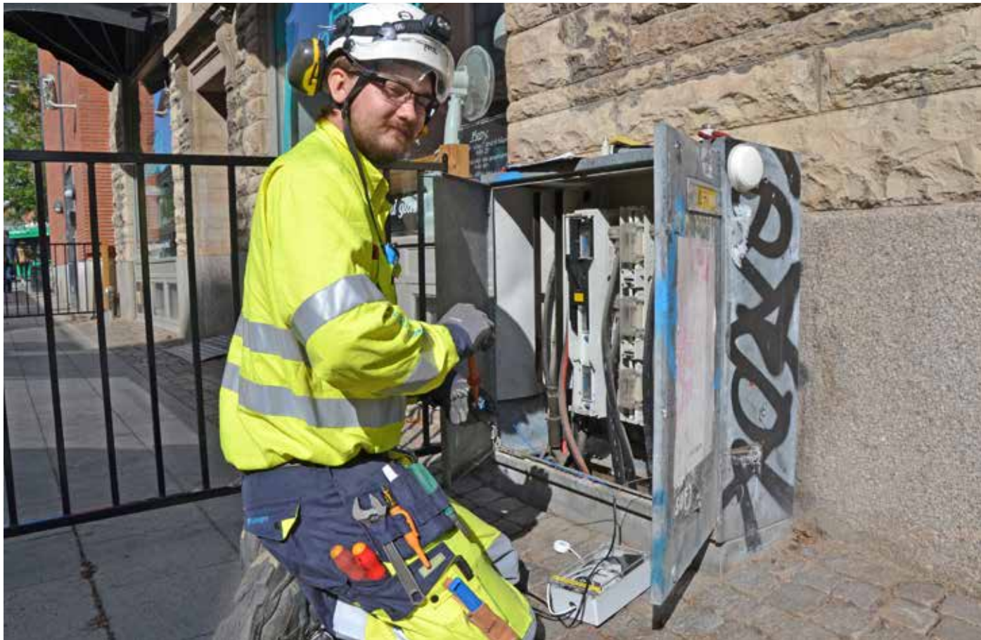
Hampus Lindgren på Kraftringen installerade sensorer i kabelskåpen i centrala Lund.
